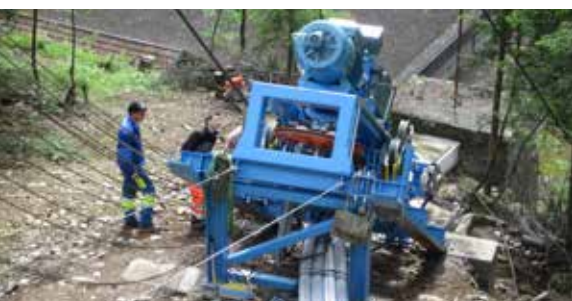
Die Materialseilbahn wurde von der PORR SUISSE AG, mit Geschäftssitz in Altdorf, realisiert.
