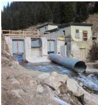
Wasserfassung mit Wehranlage
