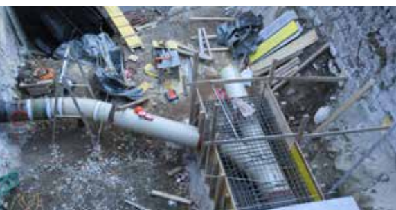
Verteilleitung im Bereich Vorplatz Kraftwerkszentrale
