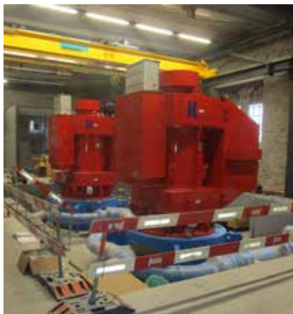
Kraftwerkszentrale mit den Generatoren
