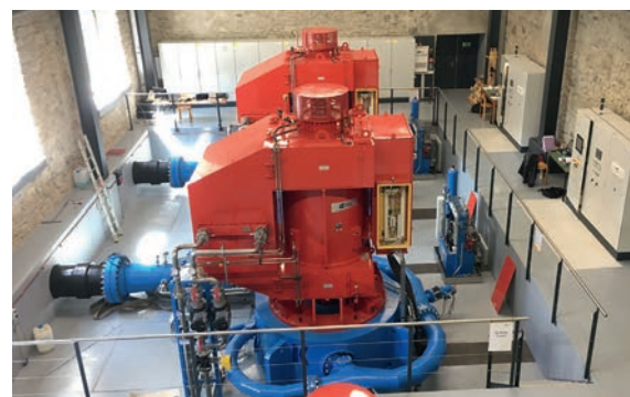
Die erneuerte Kraftwerkszentrale in Gurtneilen mit den vertikalen Turbinen.
